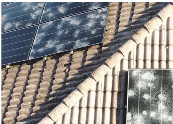
2. Danni all'impianto fotovoltaico
